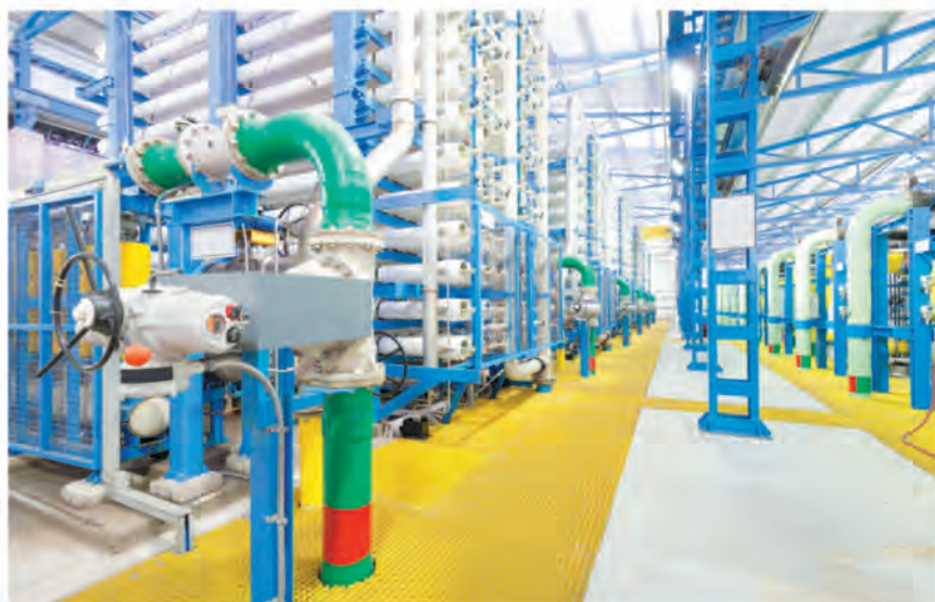
Fotografía del interior de los bastidores de ósmosis inversa de una planta desaladora.
