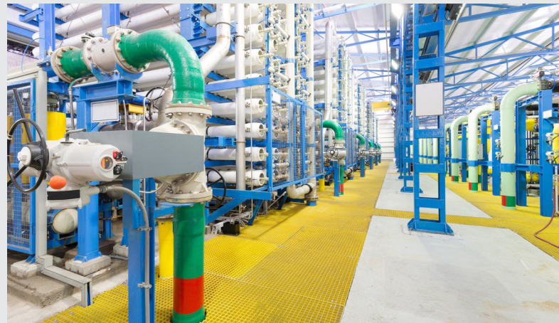
Bastidores en la zona en la que se lleva a cabo la ósmosis inversa en una planta desaladora.
